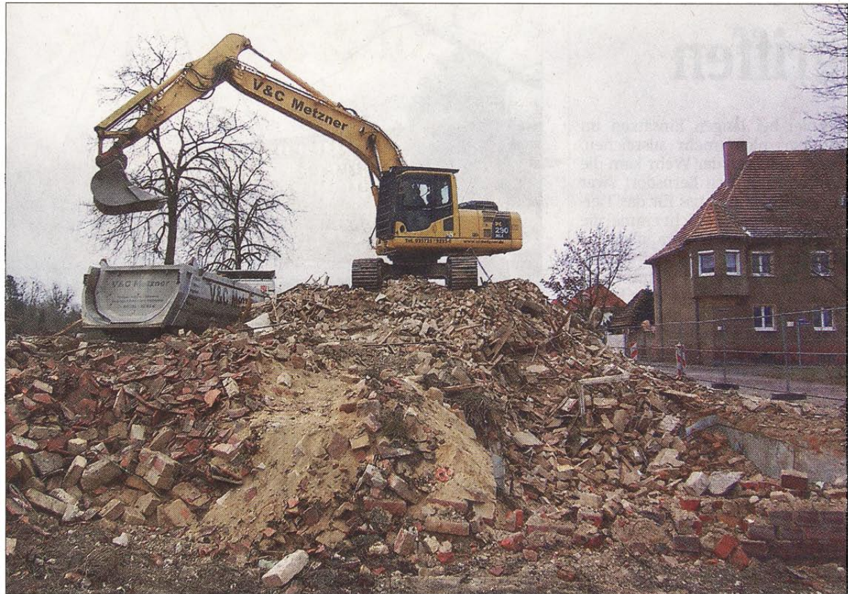
Dieser Bagger steht auf den Überresten des Mehrfamilienhauses Oststraße 1 in der Laubuscher Kolonie. Neben der Südstraße 3 ist es eines von zwei Gebäuden im Besitz der Wohnungsgenossenschaft Laubusch, die in diesem Jahr gerade noch rechtzeitig vor dem Auslaufen der entsprechenden Fördermöglichkeit abgerissen werden. Foto: rgr
