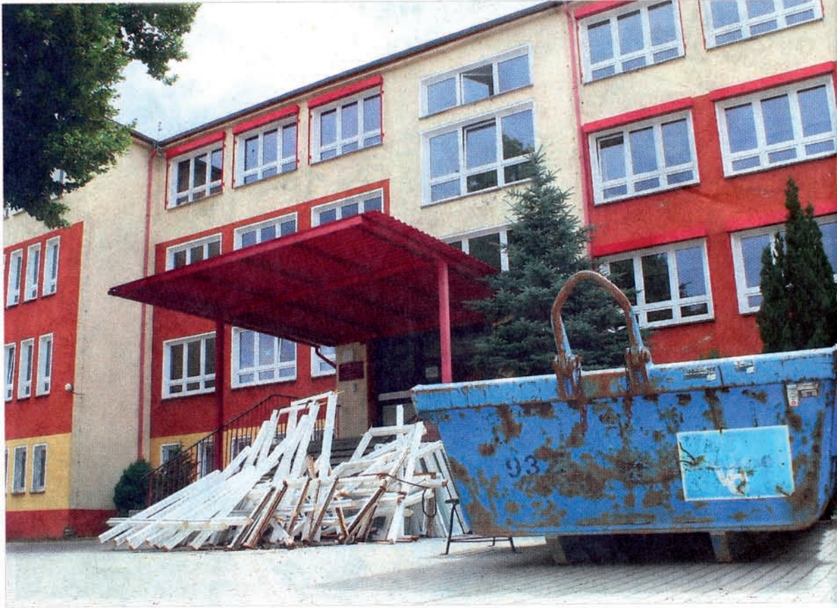
Die alten Fenster der oberen Etage der Mittelschule sind ausgebaut und stehen auf dem Schulhof. Erneuert werden die Flurfenster auf der gegenüberliegenden (Straßen-)Seite. Es ist der letzte Abschnitt der Sanierung. Foto: h
