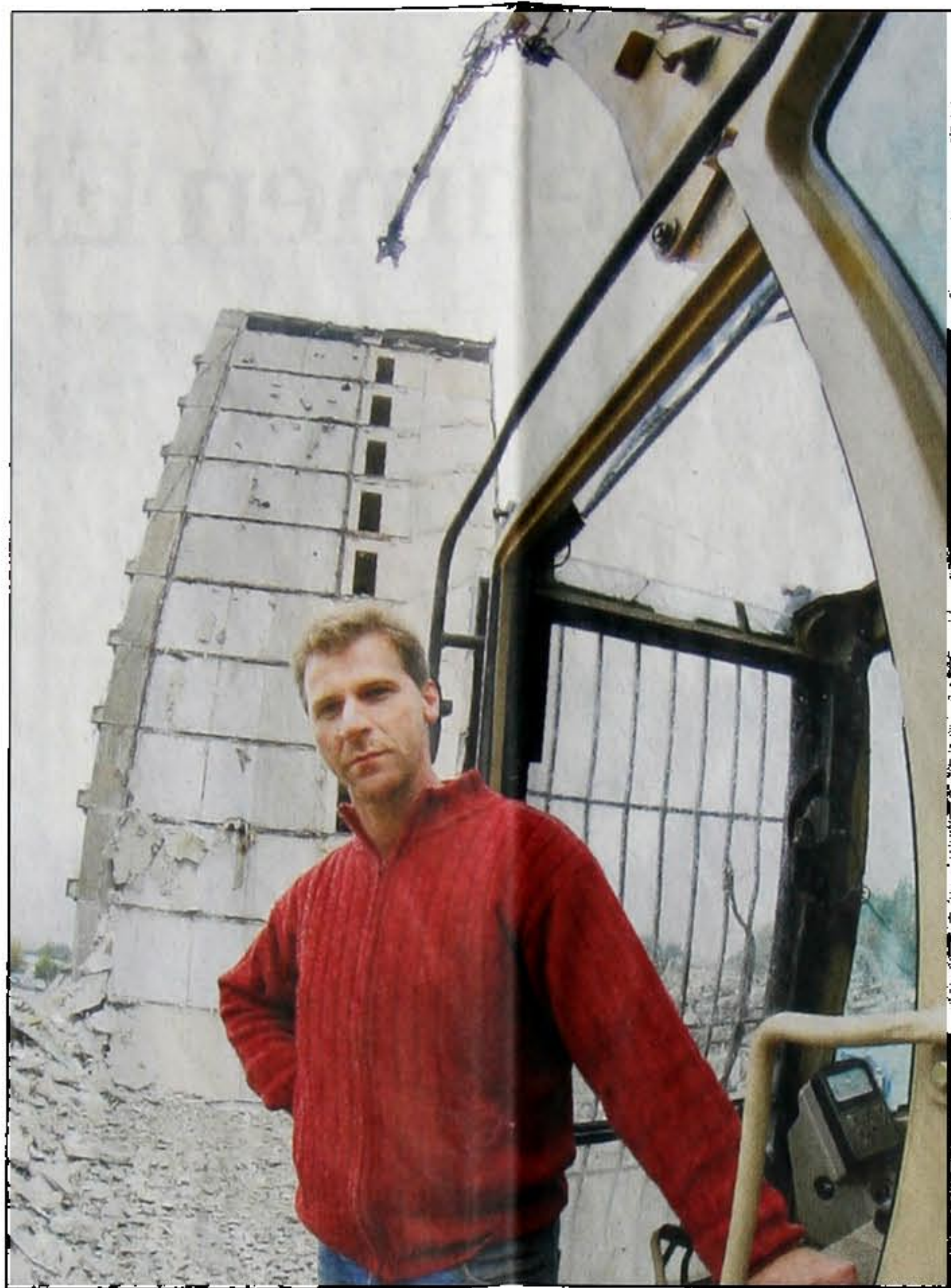
Baggerfahrer Thomas Brandt aus Stendal steht neben dem Führerhaus seiner Spezialmaschine. Deren Ausleger ist 40 Meter lang – damit reicht er bis zum elften Stock des Hochhauses an der Bautzener Nagelstraße. Fotos: SZ/Uwe Soeder
